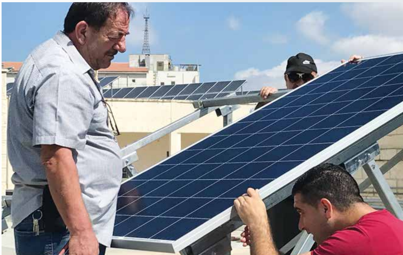
Montaggio di pannelli solari sul tetto della Scuola Tecnica Salesiana a Betlemme
