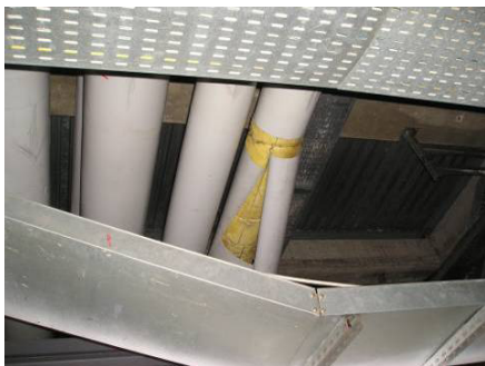
Figura 6: vista stato isolamento rete distribuzione
