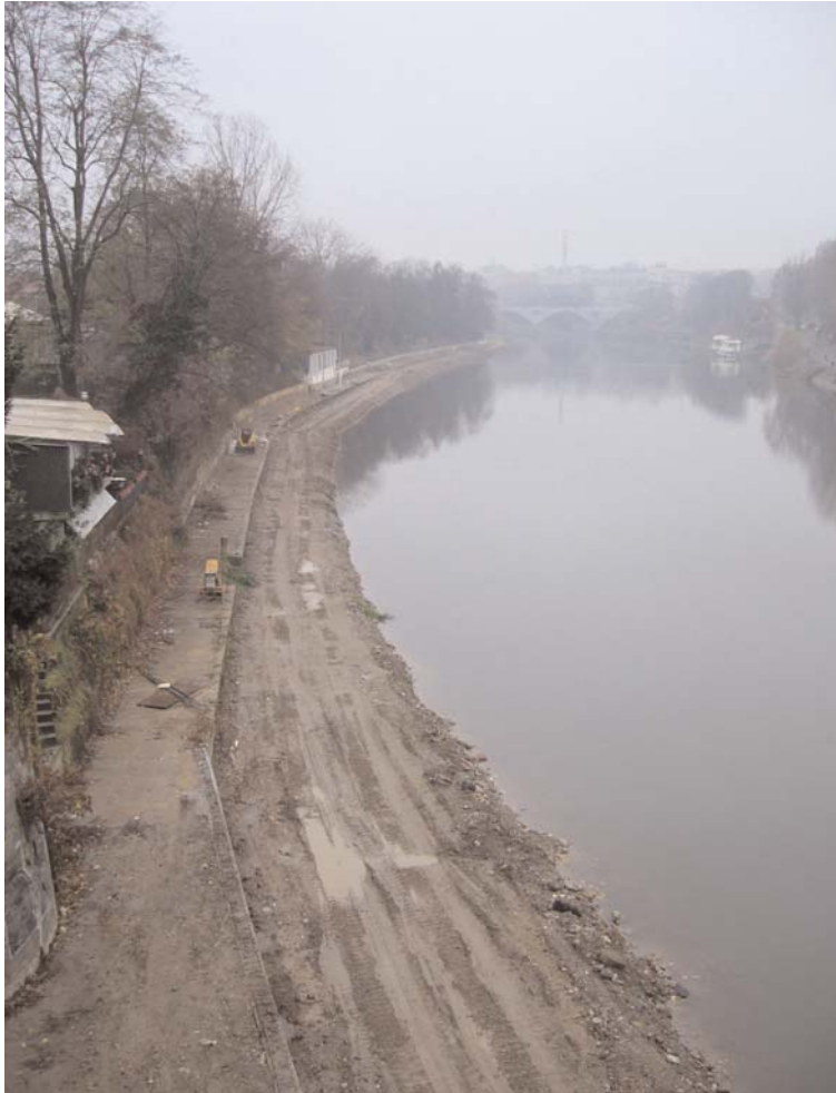
I lavori di costruzione della pista ciclabile sulla sponda destra del Po.
