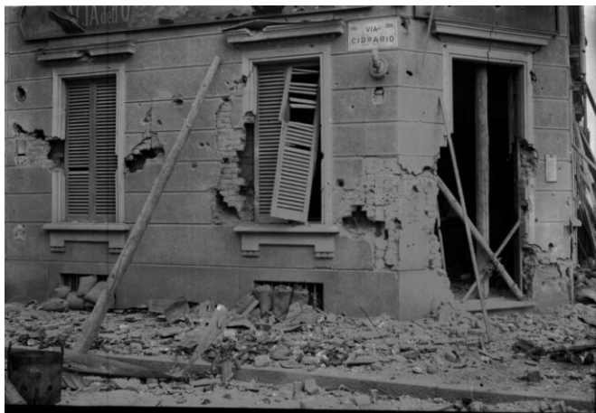
I danni all'edificio della Farmacia Ospedaliera
