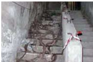
Le scale di accesso invase dalle radici degli alberi (foto arch. Adorno)
