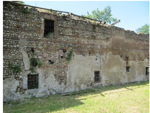
Cascina La Nuova in stato d'abbandono, 2017
