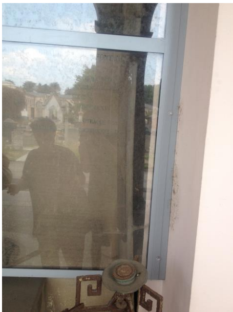
Deformazione e distacco lastra marmorea di rivestimento della parasta destra e della deformazione
