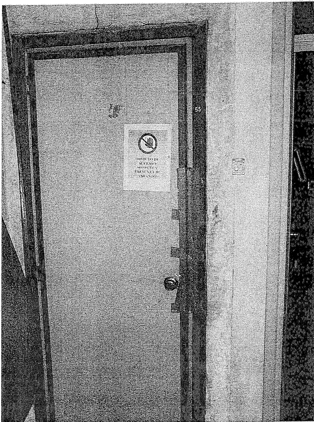
Foto n° 2: porta di accesso al locale, segnalazione della presenza di amianto
