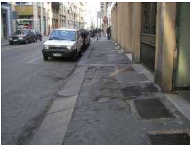
Un marciapiede di via Principe Tommaso in evidente stato di degrado
